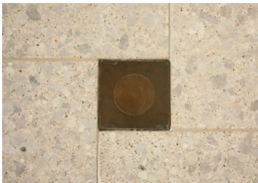
Вывод кабеля через тубус бронзового цвета в Новом Музее в Берлине
