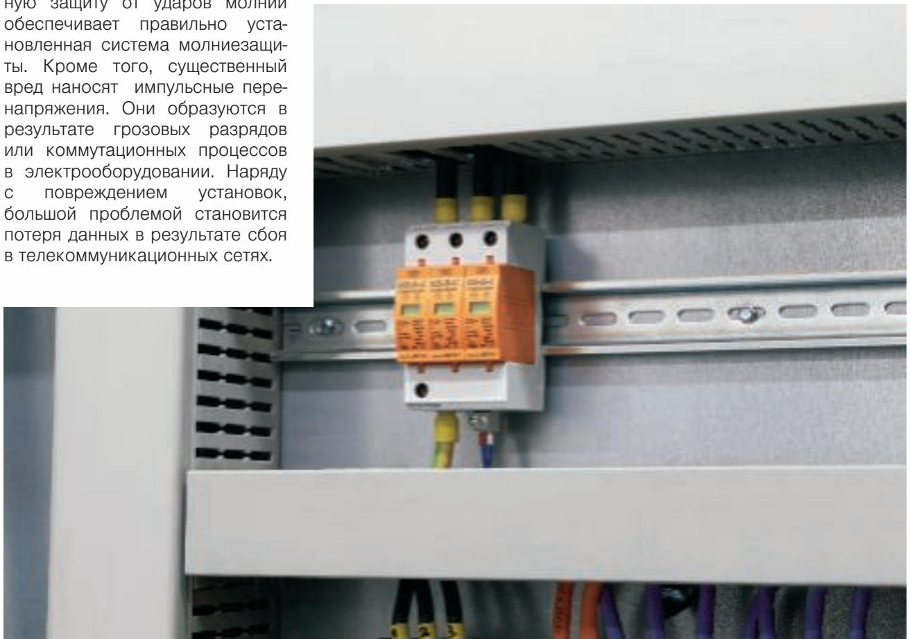
Комбинированный разрядник в распределительном шкафу.
