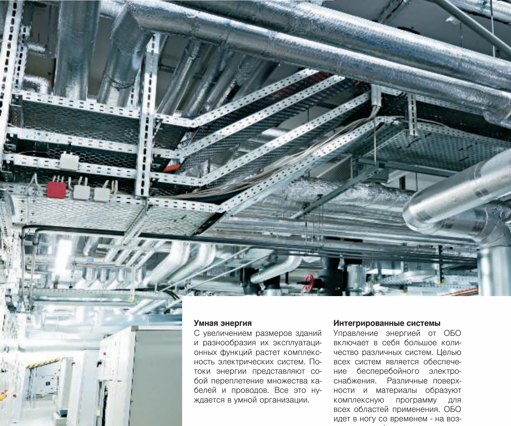
Система кабельных лотков
